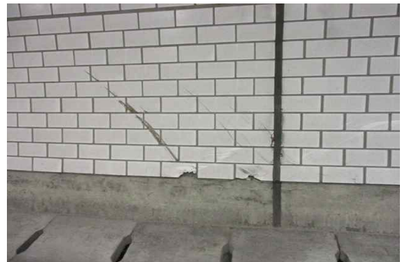
측벽부 SPAN.25 타일 파손
