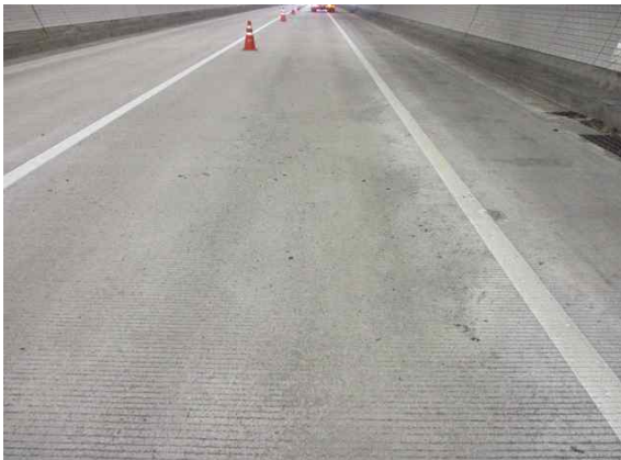
포장부 SPAN.23 포장열화
