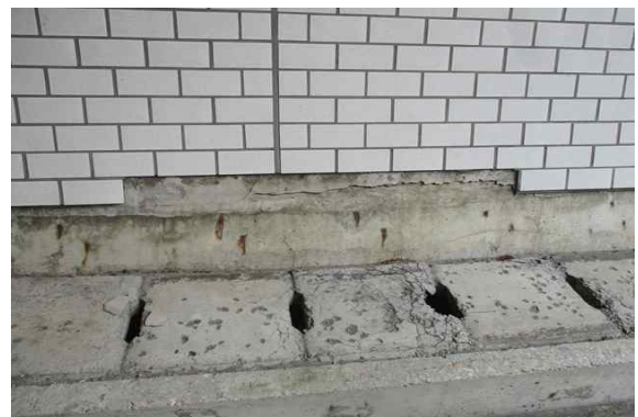
측벽부 SPAN.34 타일 탈락
