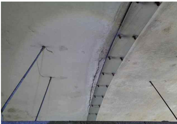
라이닝 SPAN.3 조인트부 들뜸
