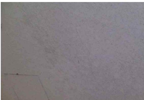
라이닝 SPAN.25 균열(0.3mm이상)
