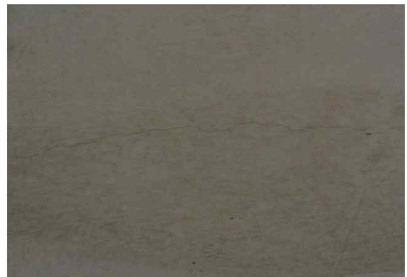
라이닝 SPAN.24 균열(0.3mm이상)
