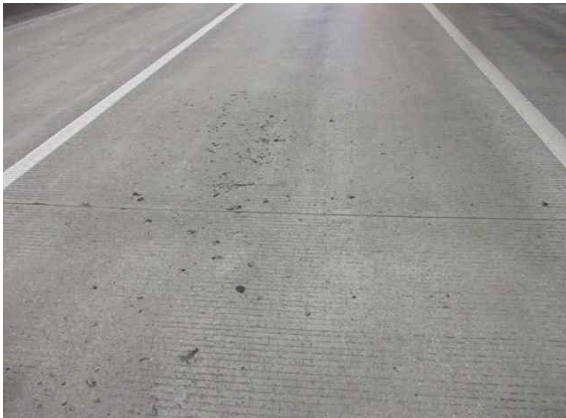
포장부 SPAN.9 포장열화
