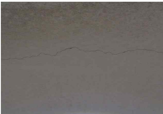
라이닝 SPAN.22 균열(0.3mm이상)
