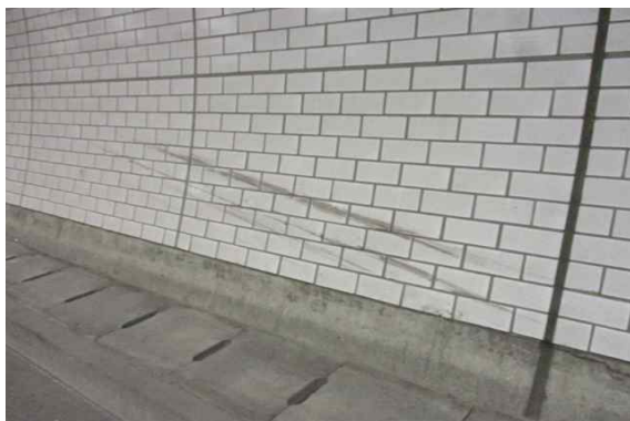
측벽부 SPAN.26 타일 굽힘
