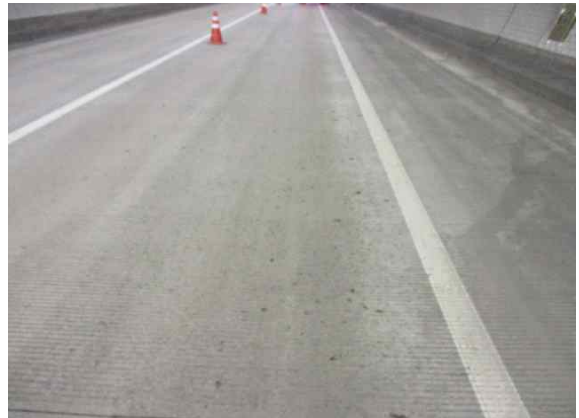
포장부 SPAN.16 포장열화
