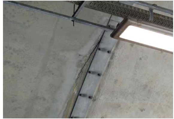
라이닝 SPAN.3 조인트부 들뜸
