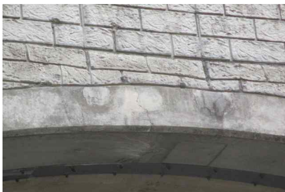
시점부 갯문 균열( cw=0.3\text{mm} 이상)
