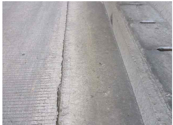
포장부 SPAN.32 포장균열(0.3mm 미만)
