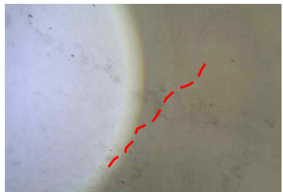
라이닝 SPAN.34 균열(0.3mm미만)
